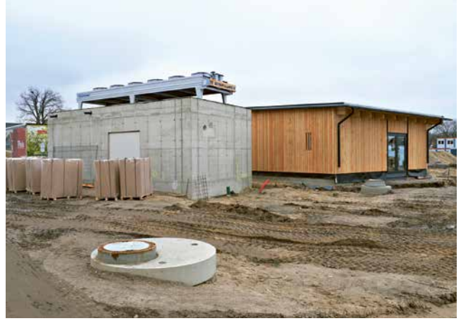
Immer passend temperiert: Der Rückkühler auf dem Dach der Energiezentrale (links im Bild) führt im Sommer Wärme ins Erdreich ab.
