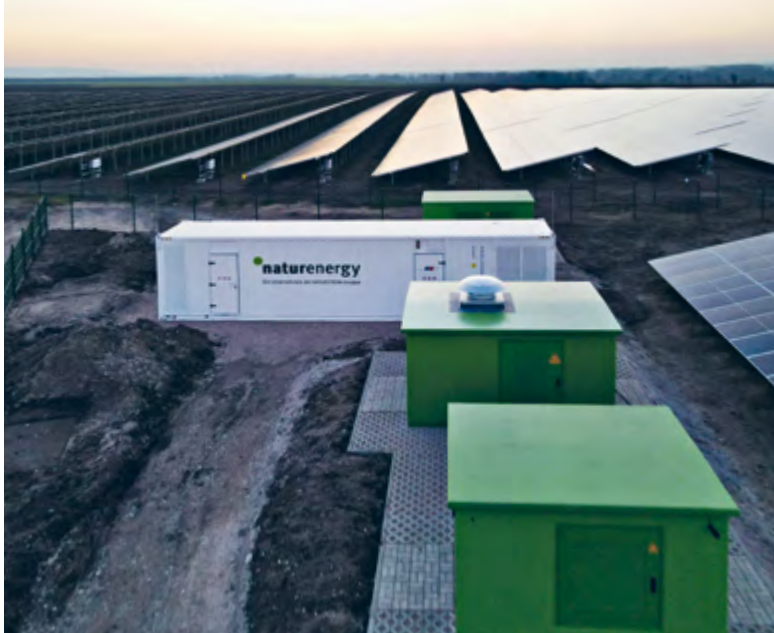
Der Solarpark Henschleben ist das Erzeugungsprojekt mit Speicher und gleichzeitig das erste Vorhaben unter dem Dach der NaturEnergy
